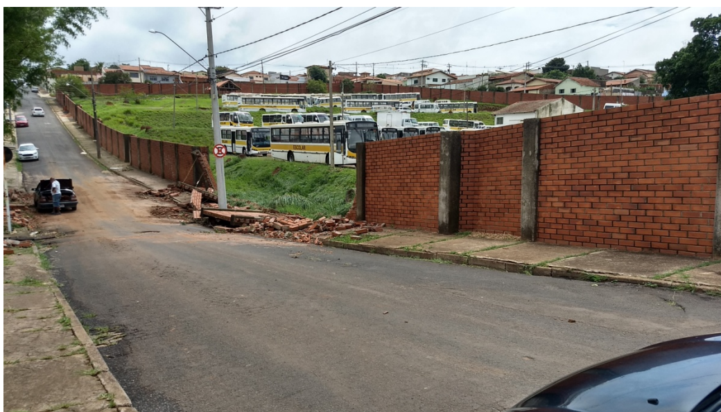
Foto 02 – Estragos do Muro da Garagem Municipal
